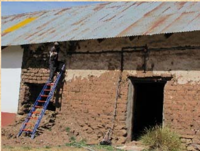
30_Die Elektrifizierung der Hacienda geht voran
